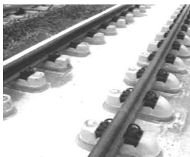
Slika I-7. Nemačko rešenje " Hochtief " sa naknadno betoniranim šinskim osloncima koji su armirani čeličnim vlaknima, na armirano-betonskoj ploči koja je izvedena na licu mesta [2]
